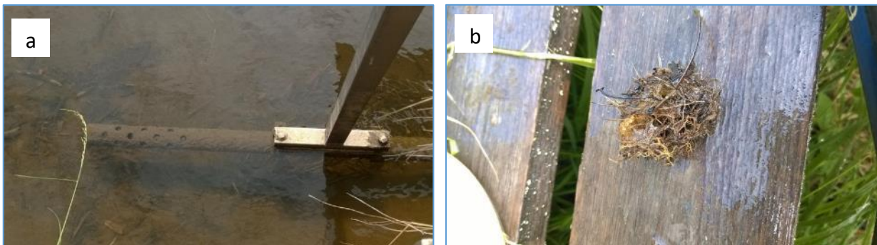
Kuva 1. Kaukanaronojan YSI-vedenlaatumittari ennen huoltoa (a) sekä mittarin suojuksen sisälle keväällä kertynyttä roskaa (b). Kuvat: Pyhäjärvi-instituutti.
