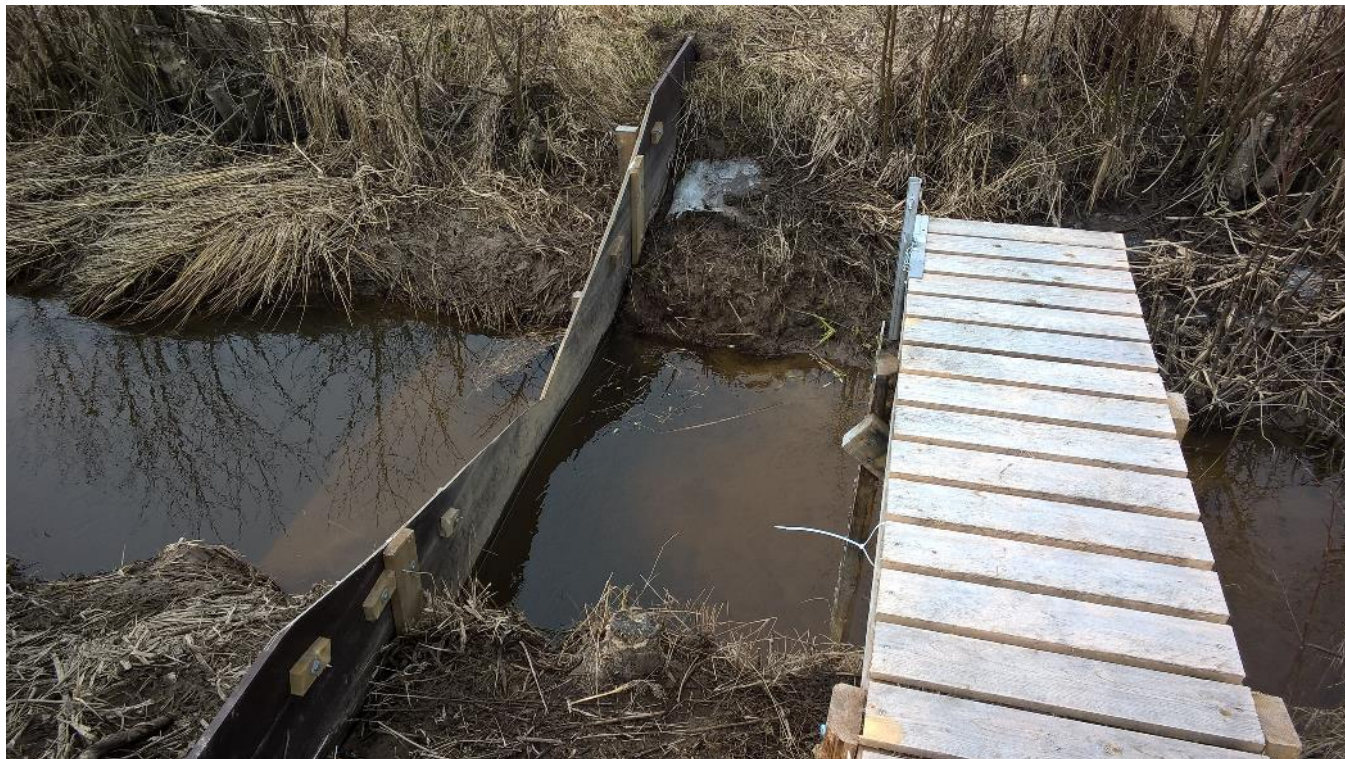
Kuva 3. Kaukanaronojan rikkoutunut mittapato. Kuva: S. Jaakkola
